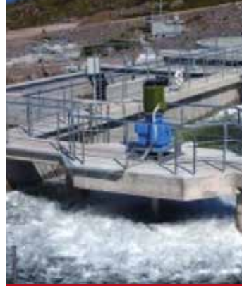
Atık Su Arıtma Tesisi
