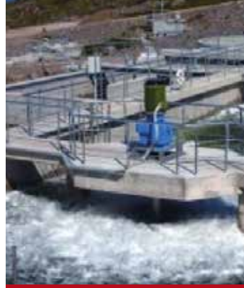
Atık Su Arıtma Tesisi
